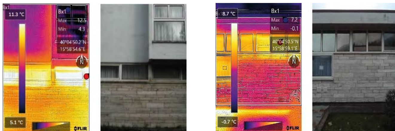
Figura 6. Termografie di alcuni elementi dell'involucro (23/10/2021 alle 18:00).
